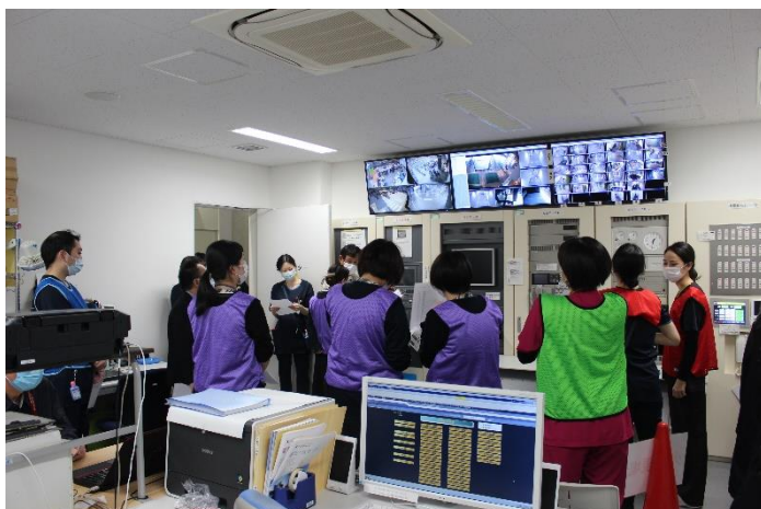
防災センターで消防設備の説明を受ける
